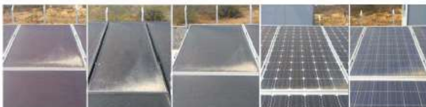
Figura 2 – Módulos fotovoltaicos com sujeira não homogênea
