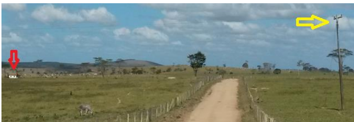
Figura 3 - Foto que mostra rede de distribuição e o ponto de entrega de energia.
