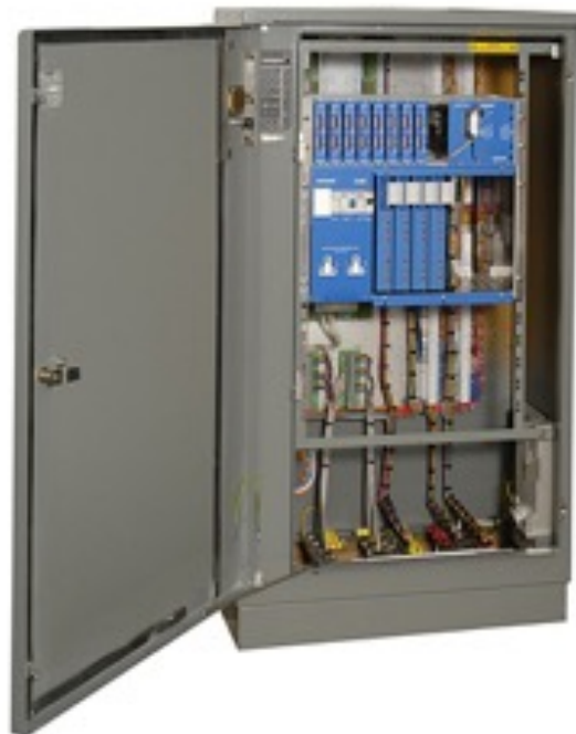
Figura 1.1.1- Controlador semafórico Siemens ST900.
